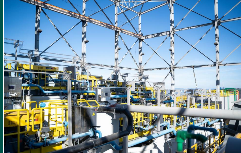
Celdas de flotación primarias
