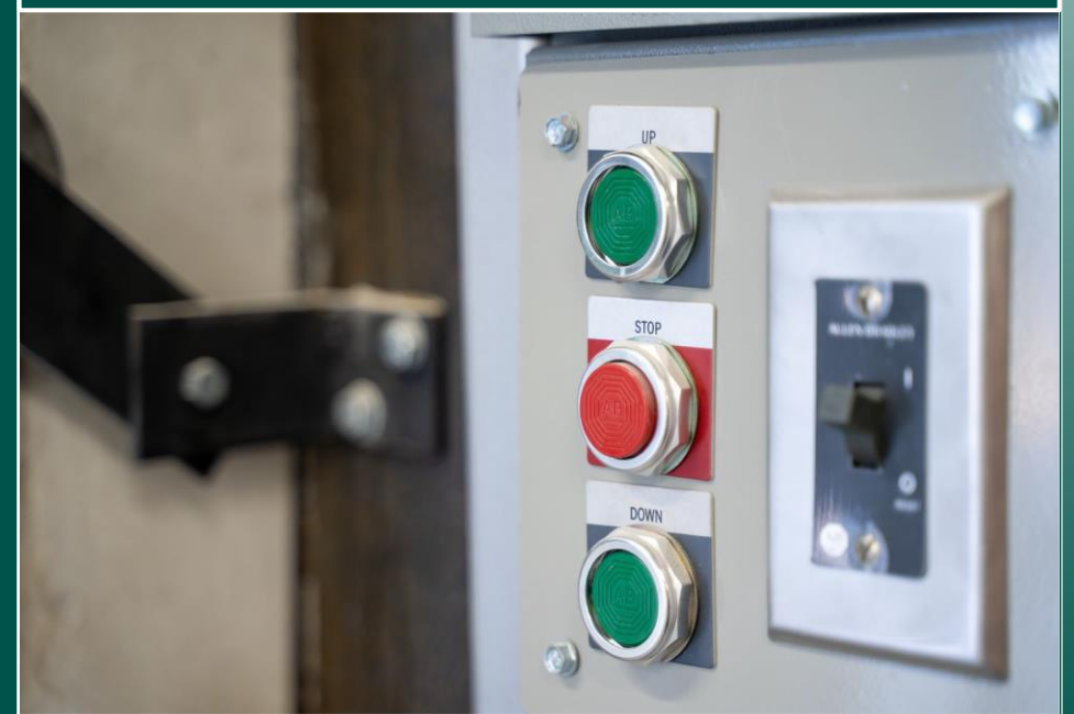
Estación de inicio/paro de equipos
