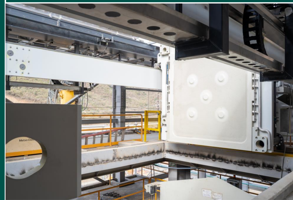
Placa del filtro de jales
