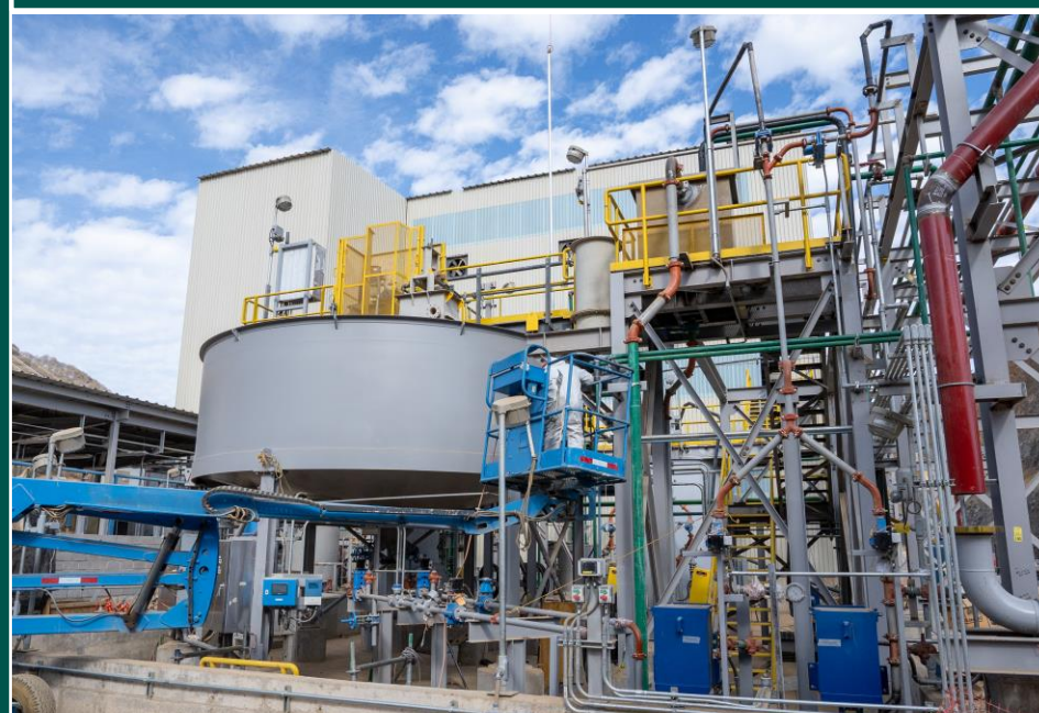
Clarificador de concentrado
