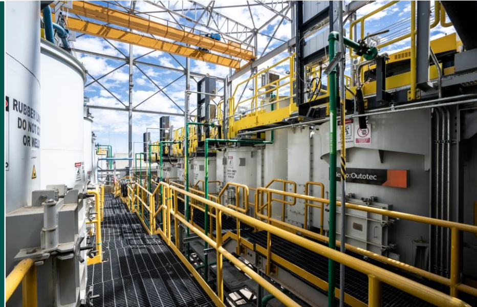
Tanques de flotación
